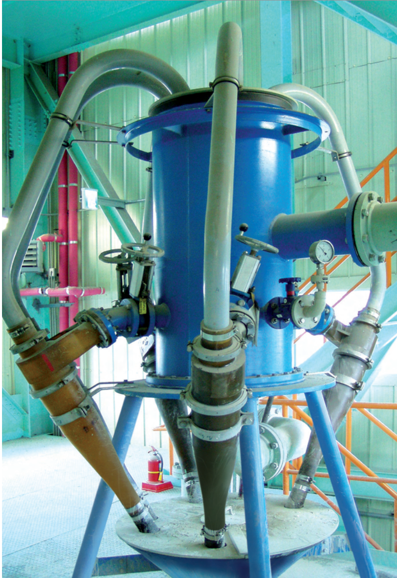
Hydrozyklone für die Vorentwässerung von Gips.
